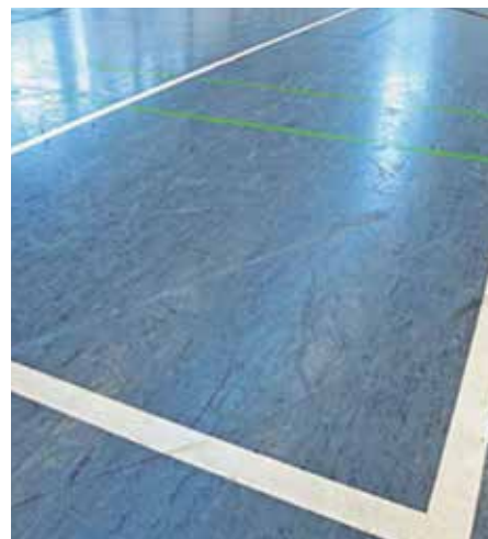
Сильно изношенное напольное покрытие
